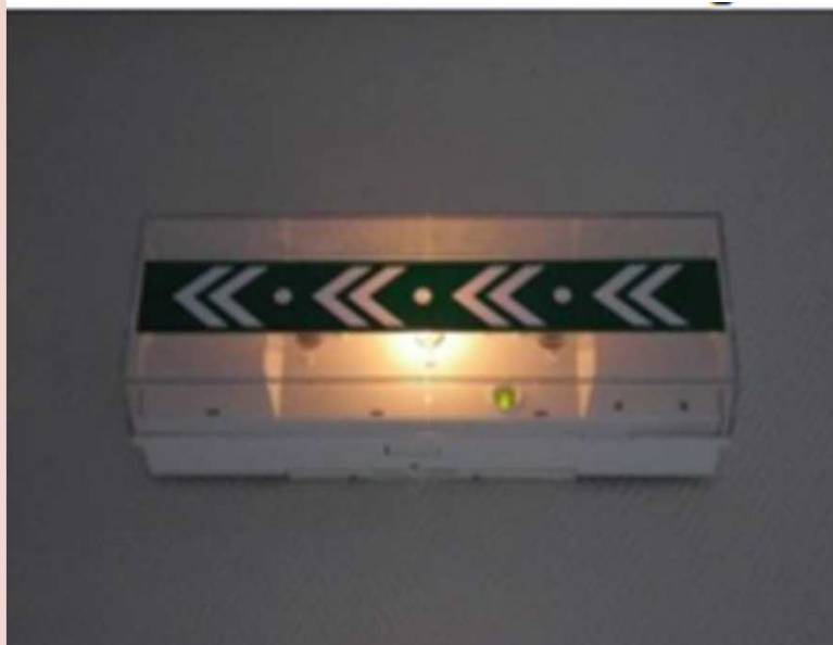
Balilage des cheminements à parcourir pour atteindre une sortie (3 situés au plafond)
