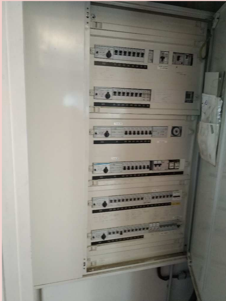
TGBT (SAS Entrée principale)
