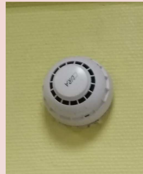
Diffuseur sonore incendie
